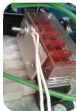
1 резистор по 5 Вт для каждого блока предохранителей
